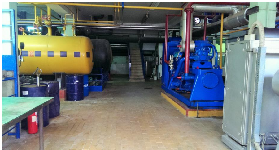
Slika 4.1. Rashladno postrojenje Osječke pivovare d.d.
