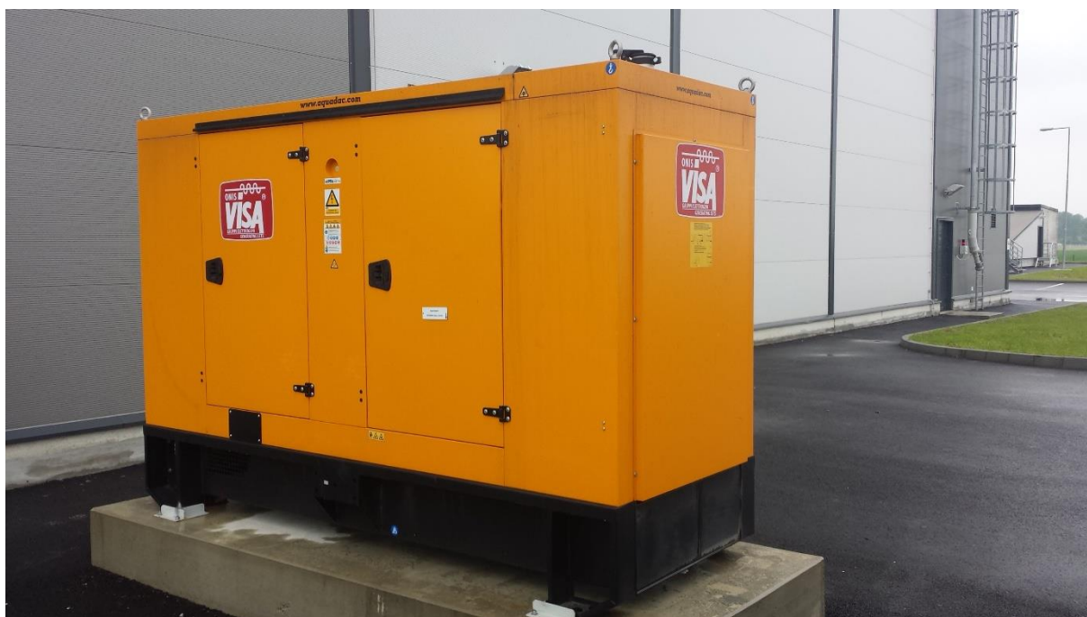
Slika 7.6. Pomoćni generator za rad u nuždi [5]
