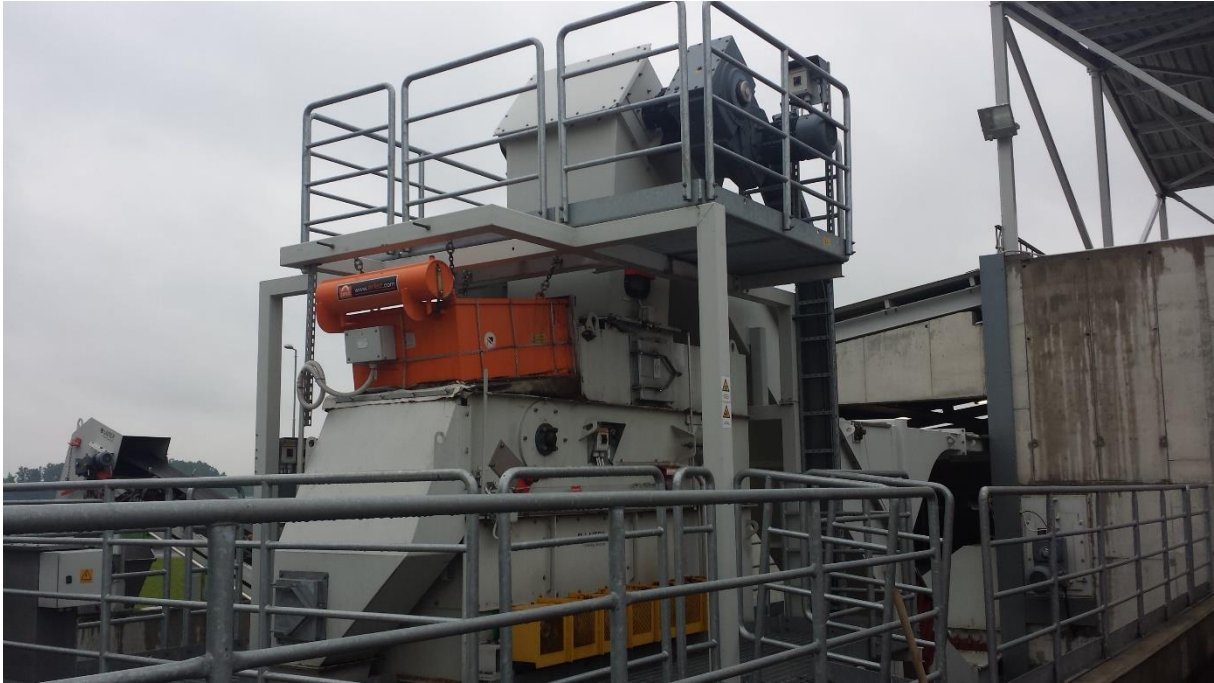
Slika 6.1. Sustav za pripremu i transport biomase do kotla [5]
