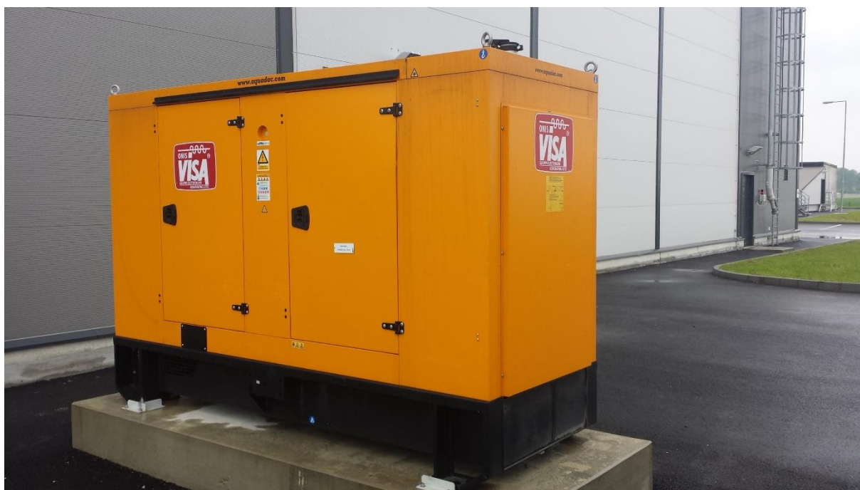
Slika 7.6. Pomoćni generator za rad u nuždi [5]
