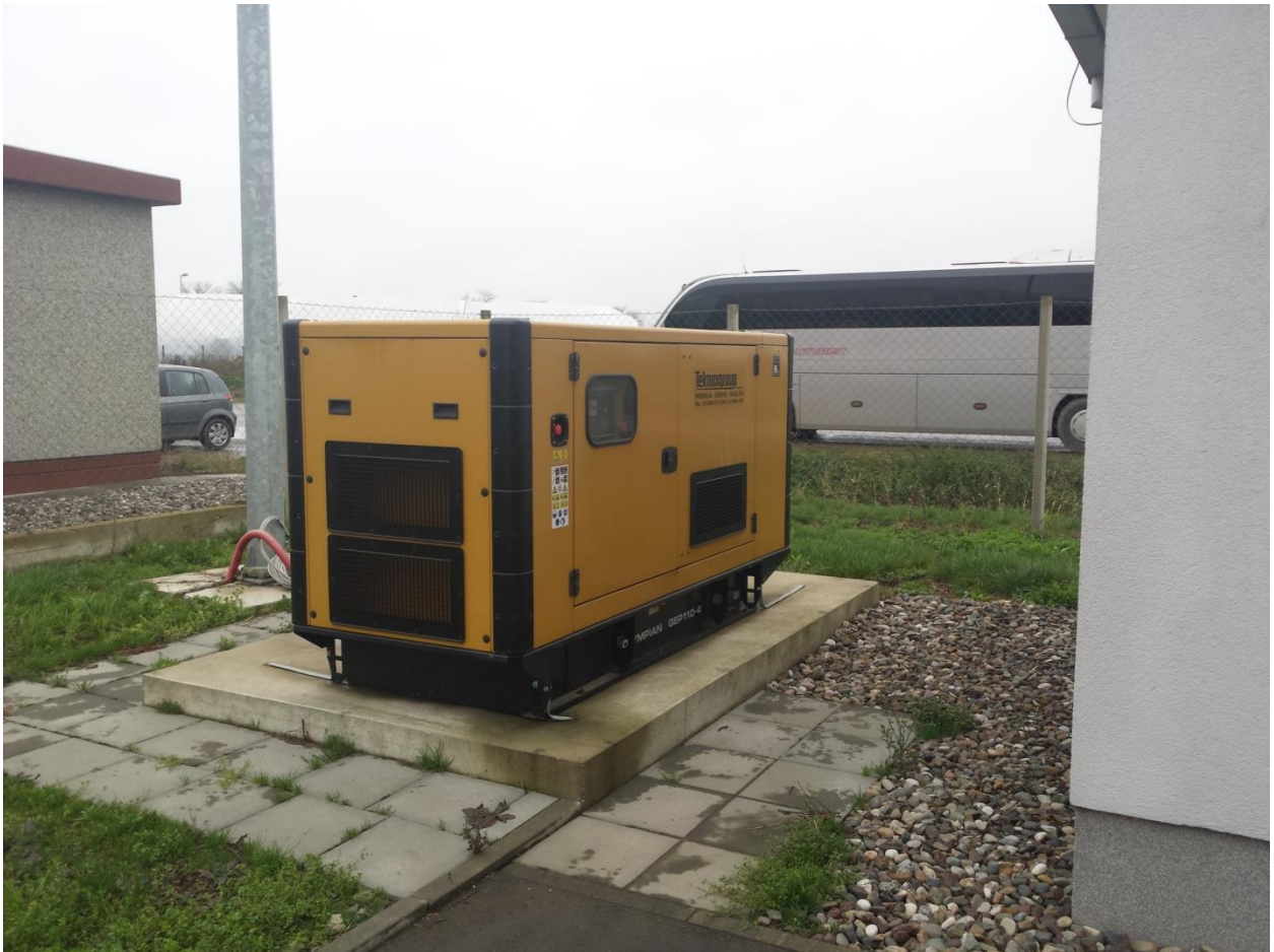
Slika 5.21. Diesel agregat [fotografirano 8. lipnja 2015.]
