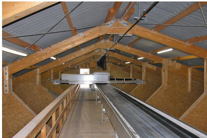
Slika 3.24. Prikaz skladišta s transportnom trakom [11]
