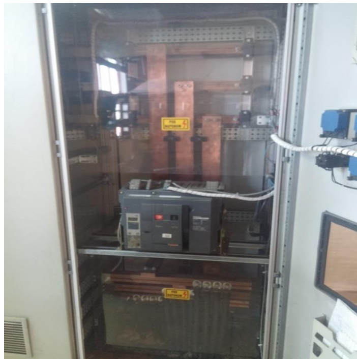
Slika 2.5. Prikaz priključnog ormara transformatora i njegove sklopke
