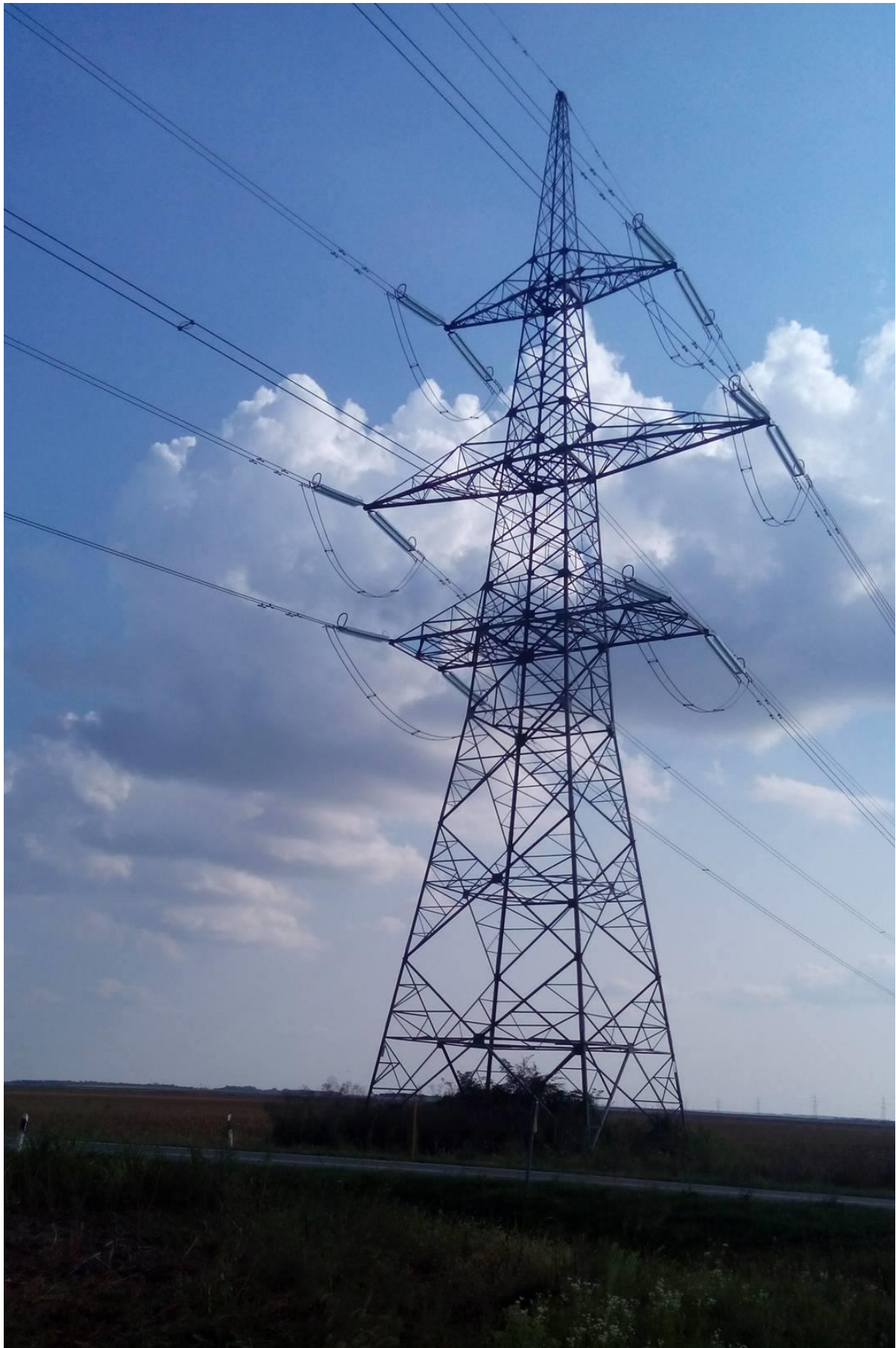
Slika 5.9. 400 kV nadzemni vod na području Petlovca, [12].
