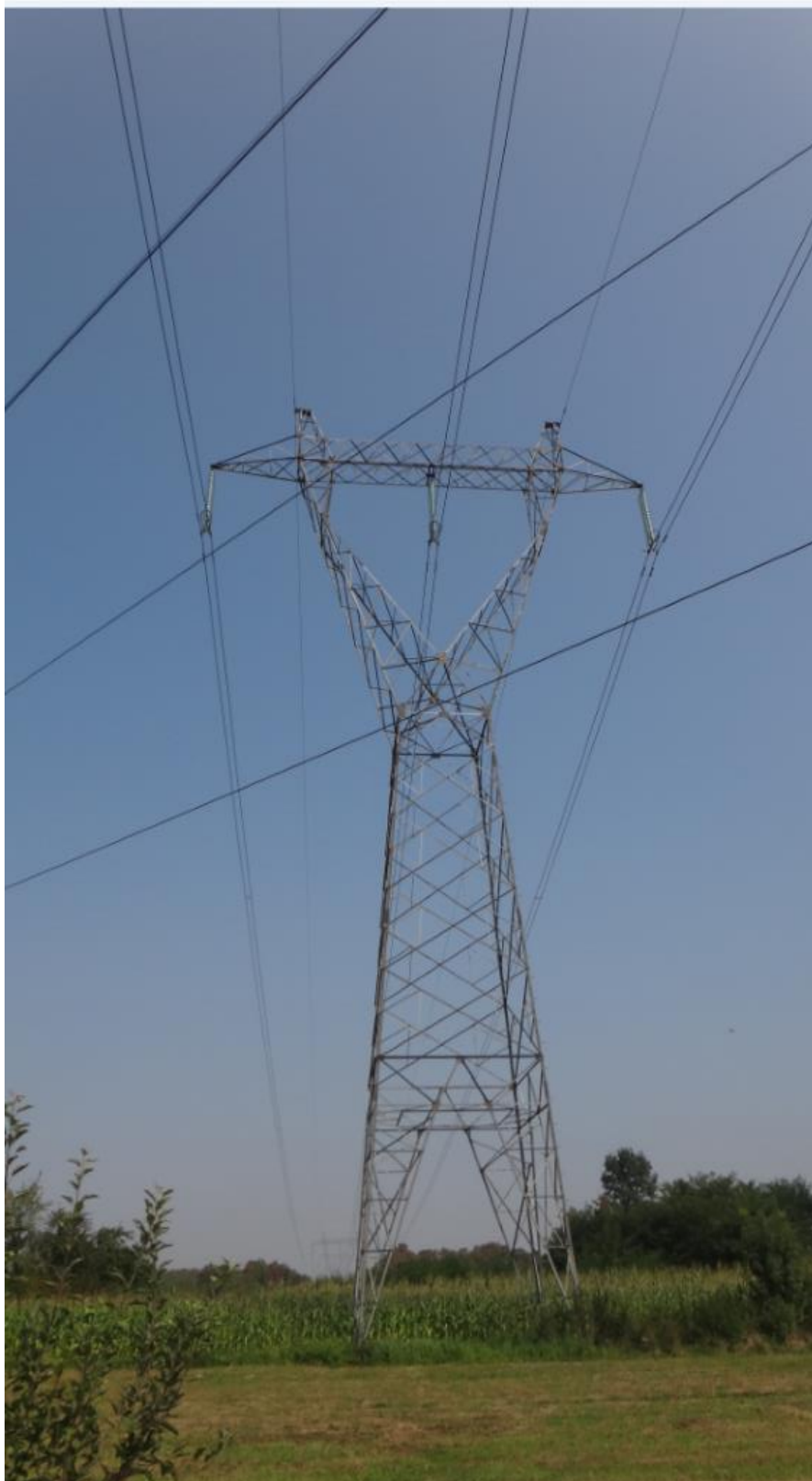
Slika 5.5. 220kV trofaznoi nadzemni vod na relaciji Đakovo-Tuzla, [13].
