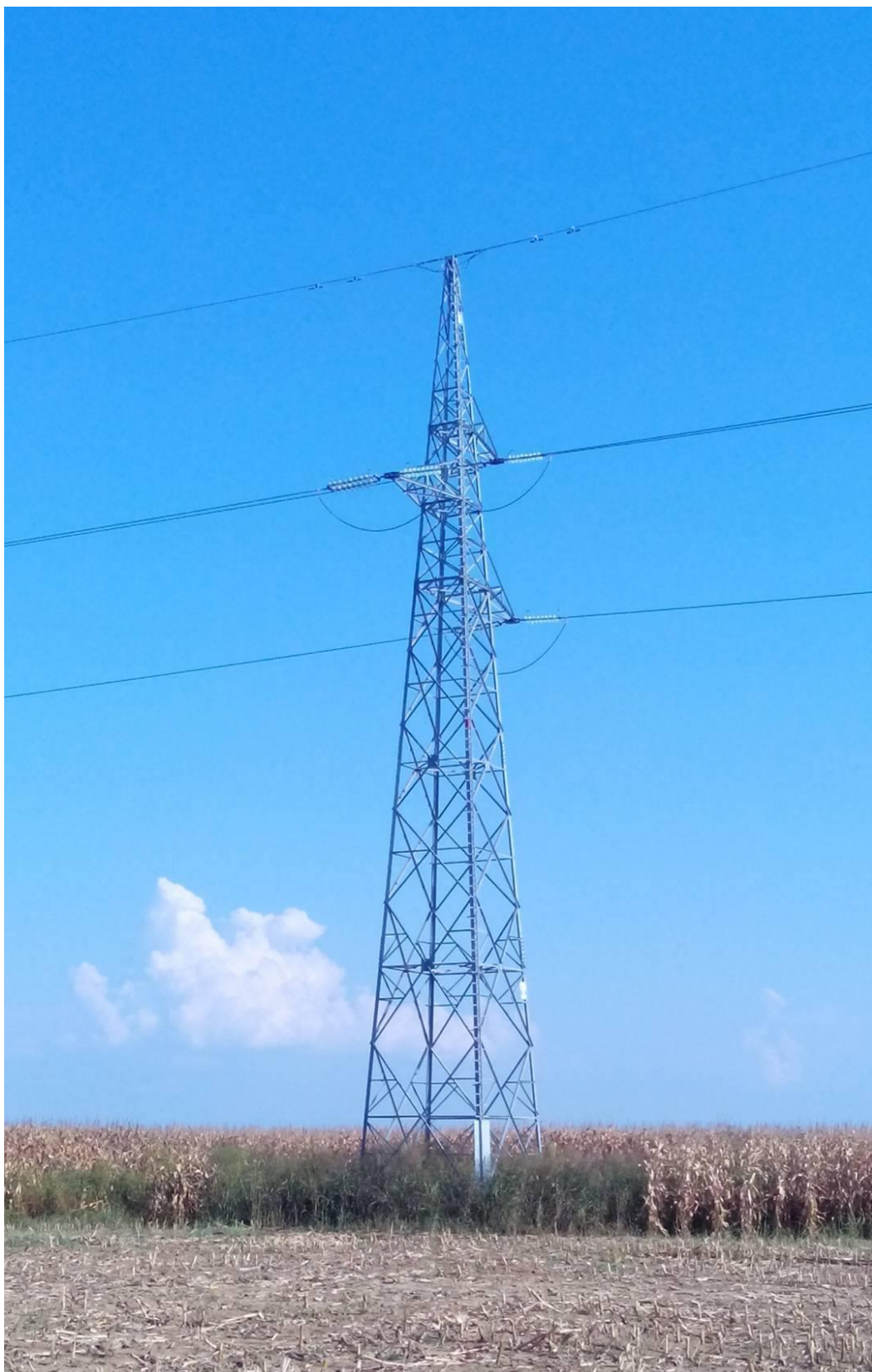
Slika 5.3. 110kV trofazni dalekovod na području Belog Manastira, [12].
