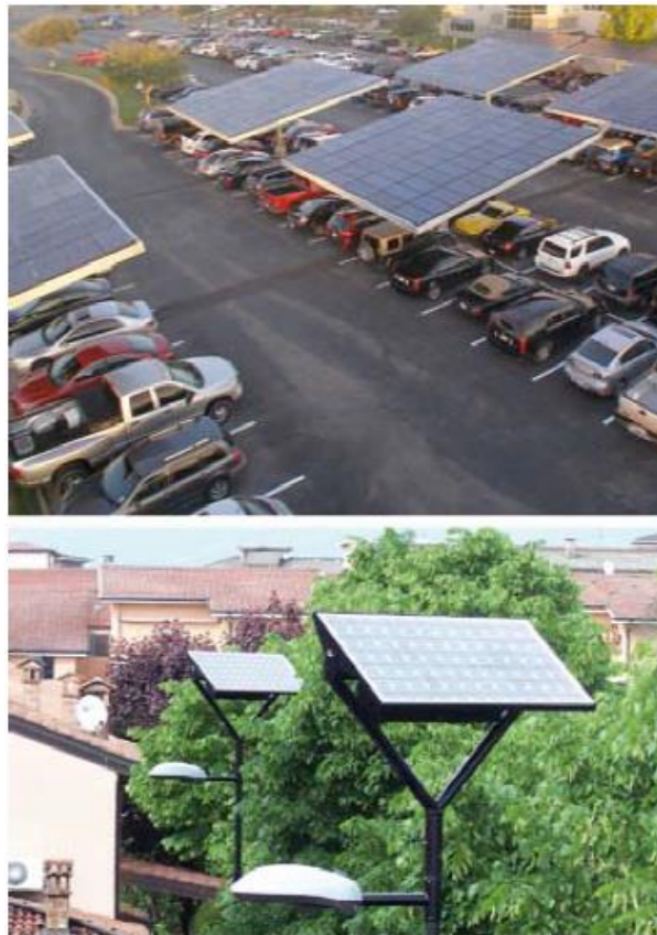
Slika 3.16. Primjeri samostojećih fotonaponskih sustava. [8]
