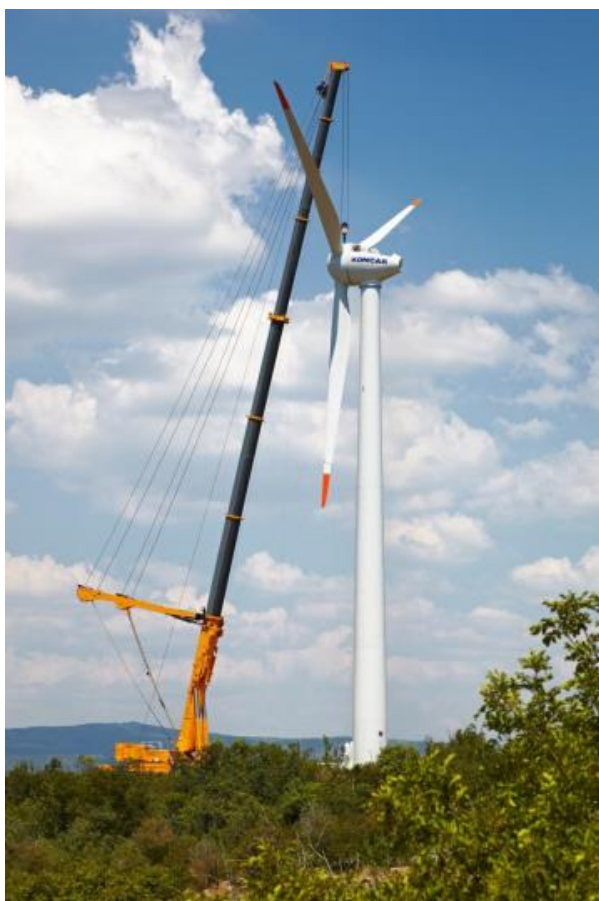
Slika 4.8: Toranj vjetroelektrane K80 2.5 MW
