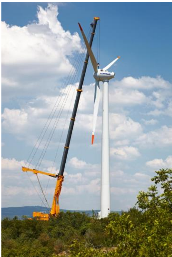
Slika 4.8: Toranj vjetroelektrane K80 2.5 MW
