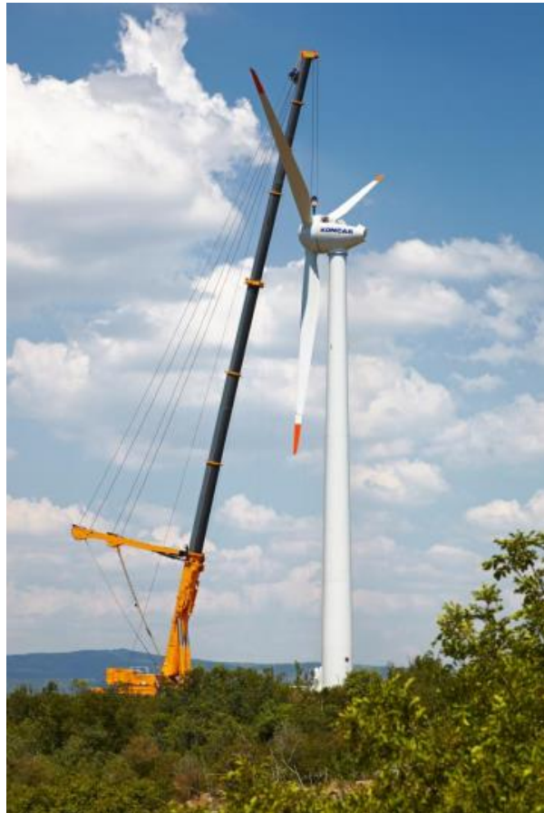
Slika 4.8: Toranj vjetroelektrane K80 2.5 MW
