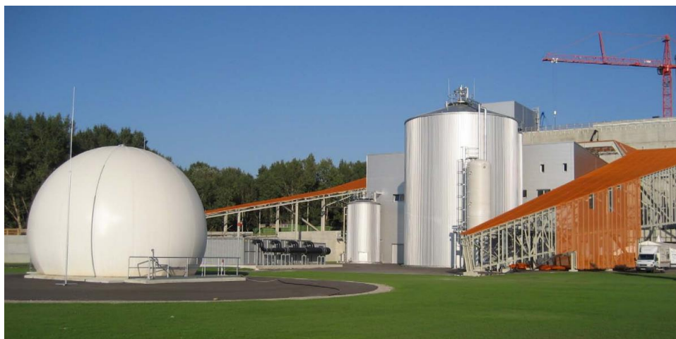
Slika 2.2. Postrojenje za proizvodnju bioplina iz ostataka hrane i pakirane hrane (Beč, Austrija) [2]
