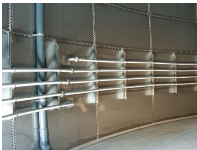
Slika 2.10. Cijevi za grijanje unutar fermentora [4]
