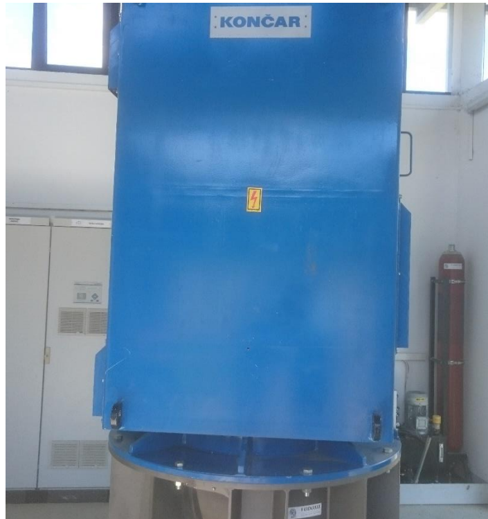
Slika 2.7. Generator male hidroelektrane „Pleternica“ [20]
