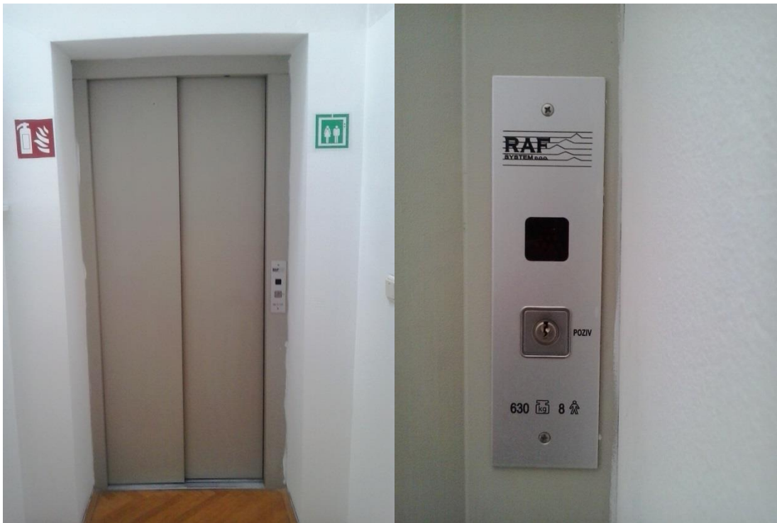
Slika 4.3. Ulazna vrata dizala i ključanica za poziv dizala.
