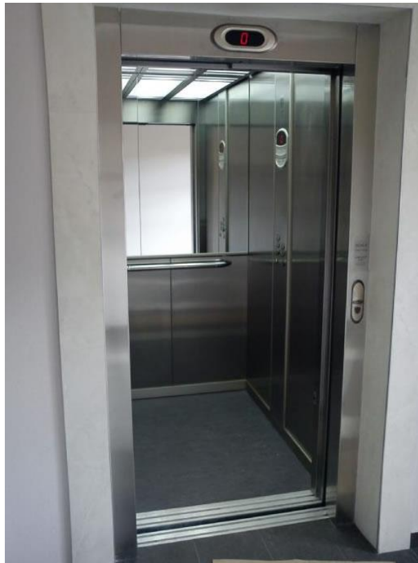
Slika 3.4. Primjer unutrašnjosti etažnog dizala [4].
