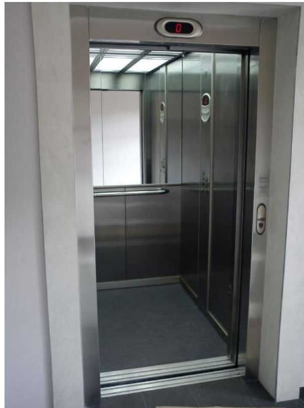
Slika 3.4. Primjer unutrašnjosti etažnog dizala [4].
