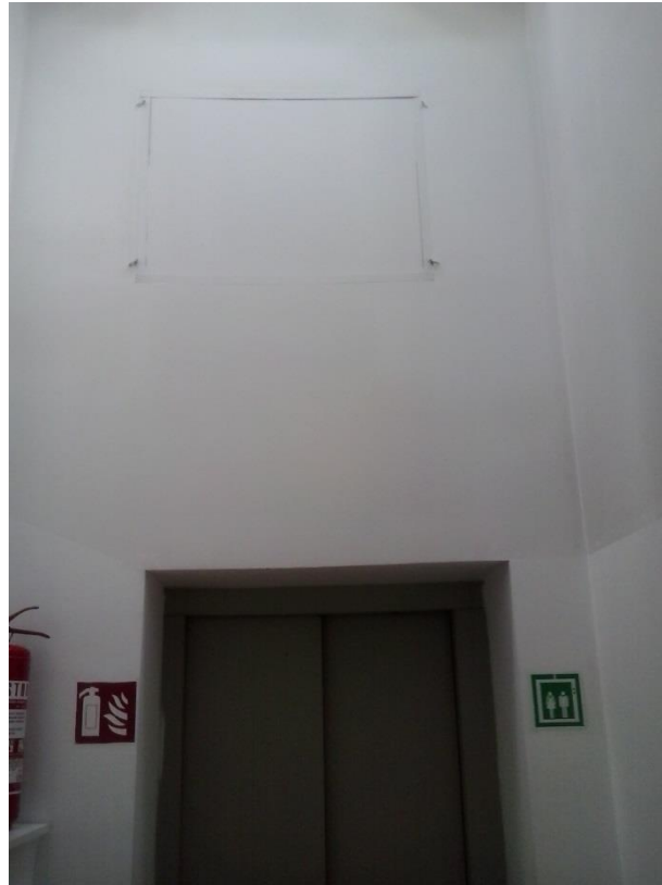
Slika 4.4. Prilaz motoru dizala iznad ulaznih vrata.
