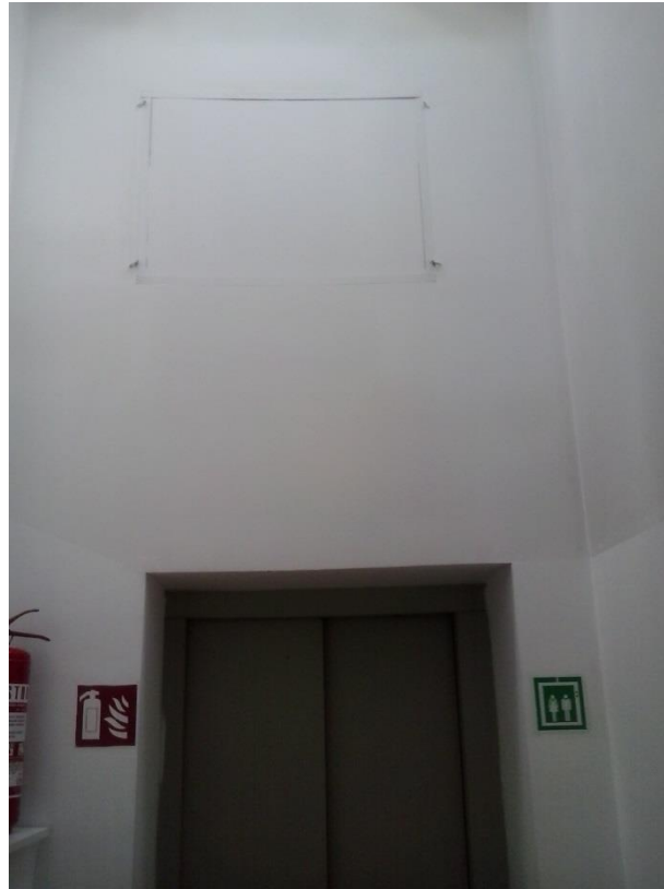
Slika 4.4. Prilaz motoru dizala iznad ulaznih vrata.
