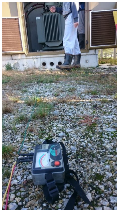
Slika 4.13. Mjerni uređaj prilikom mjerenja otpora uzemljenja transformatora (CTS)
