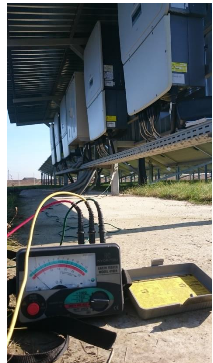
Slika 4.11. Mjerni instrument spojen na grupu invertora 3
