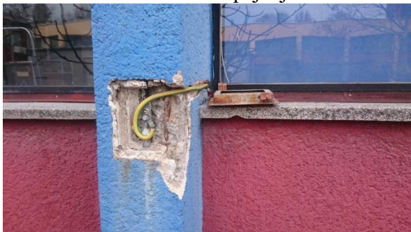
Slika 2.14 Uzemljenje uređaja preko temeljnog uzemljivača zgrade Mašinskog fakulteta
