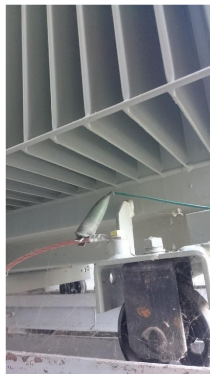
Slika 4.14. Spoj vodiča s instalacijom za uzemljenje transformatora
