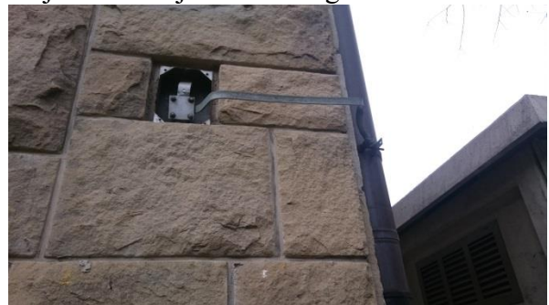
Slika 2.15 Spoj Fe/Zn trake s krova zgrade FTN-a s njenim temeljnim uzemljivačem
