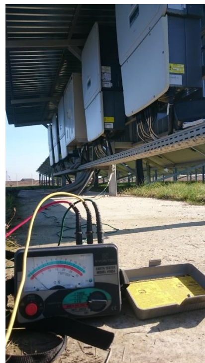
Slika 4.11. Mjerni instrument spojen na grupu invertora 3
