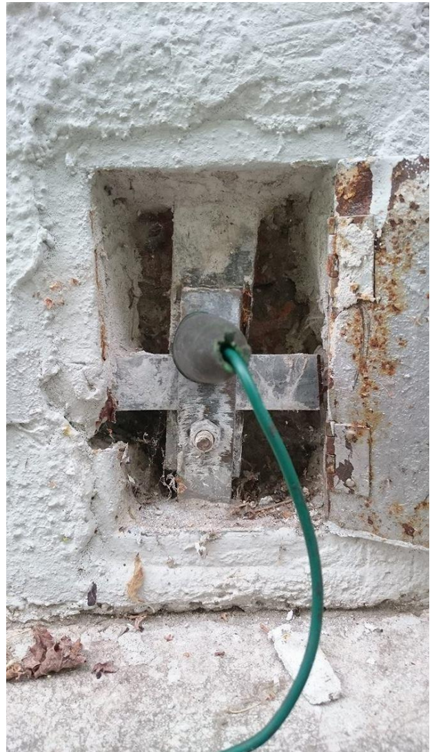
Slika 4.2. Način spajanja na uzemljivač na zgradi FTN-a
