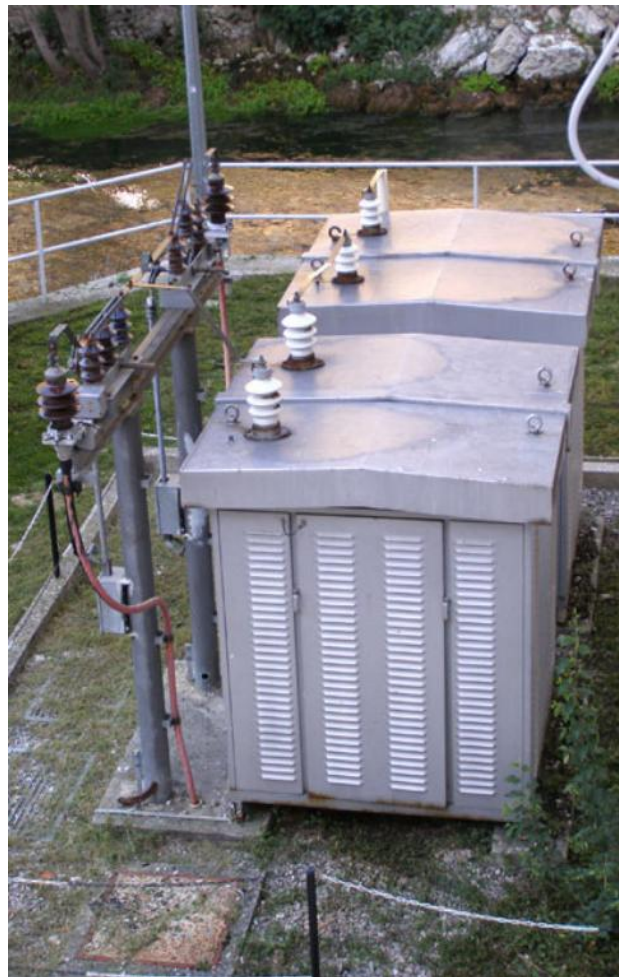
Slika 4.8. Maloomski otpornik za uzemljenje zvjezdišta 35 kV (HE Miljacka)
