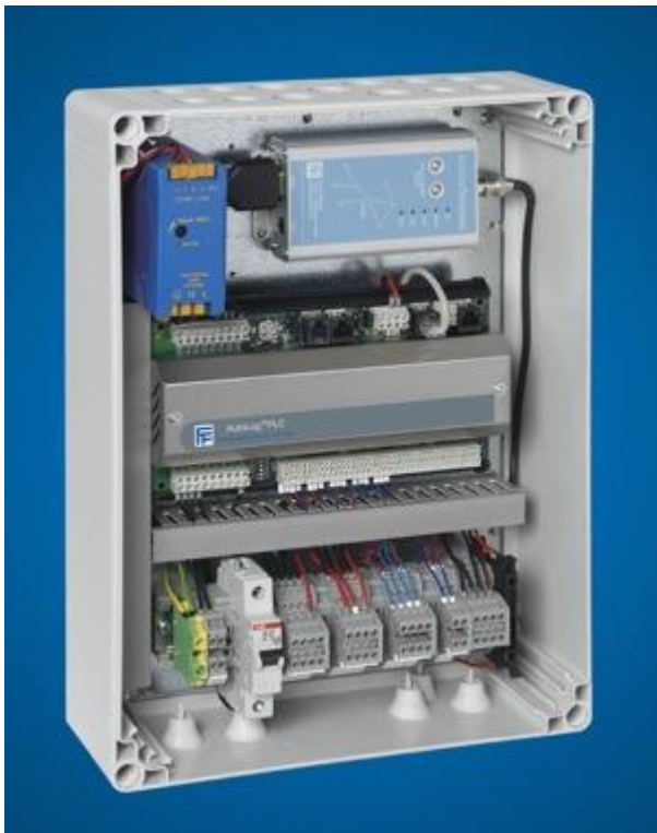
Sl. 4.2. RTU ormar[16].
