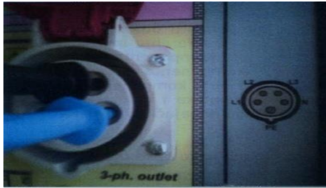
Sl. 5.2. Raspored mjernih vezica pri mjerenju impedancije trofazne utičnice
