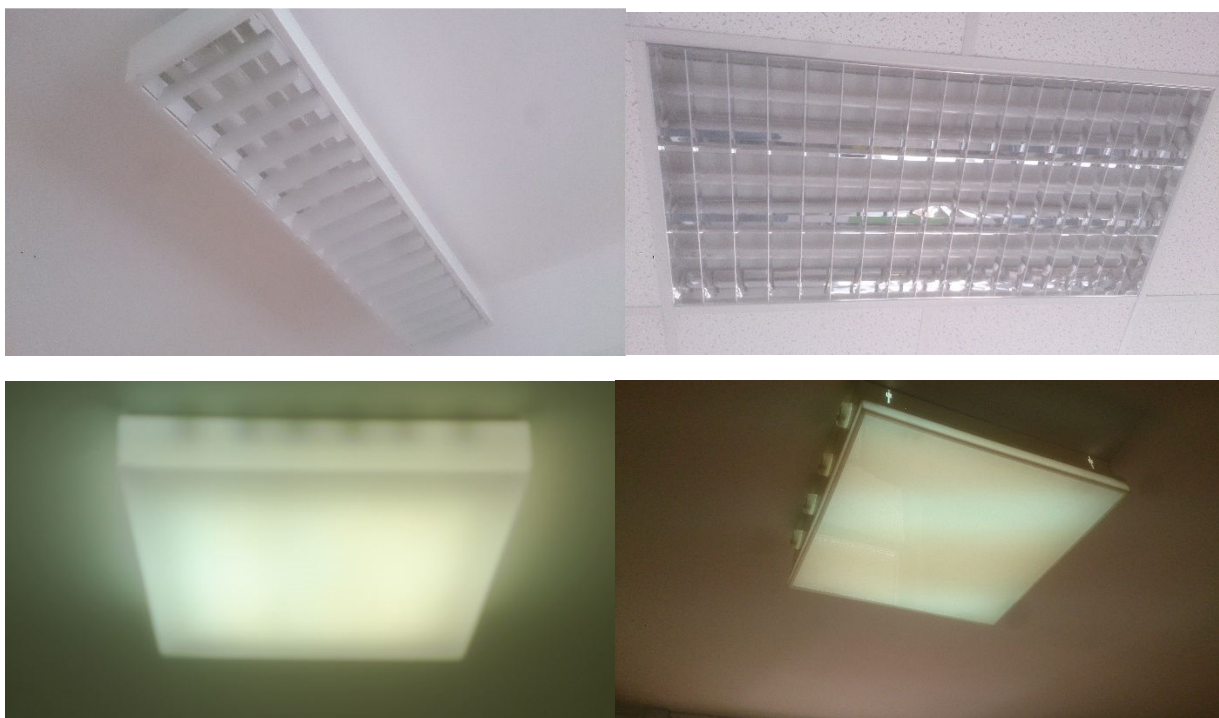
Slika 3.1. Postojeća rasvjeta objekta
