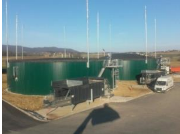
Slika 2.18. Elektrana na bioplin u Hrvatskoj - Orehovec 1.2 MW [10]
