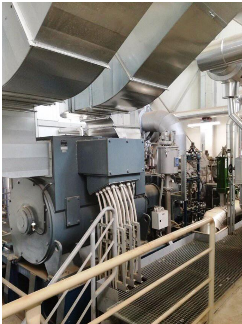
Sl. 2.2. Prikaz generatora postrojenja (slikano 14.08.2017.).
