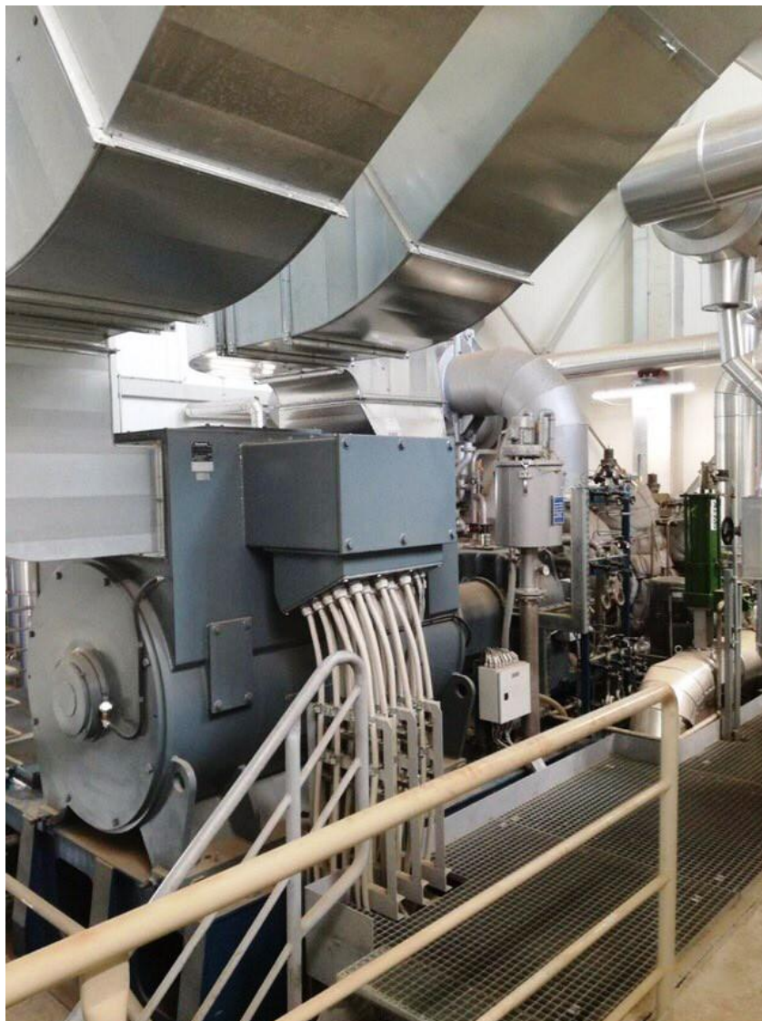
Sl. 2.2. Prikaz generatora postrojenja (slikano 14.08.2017.).
