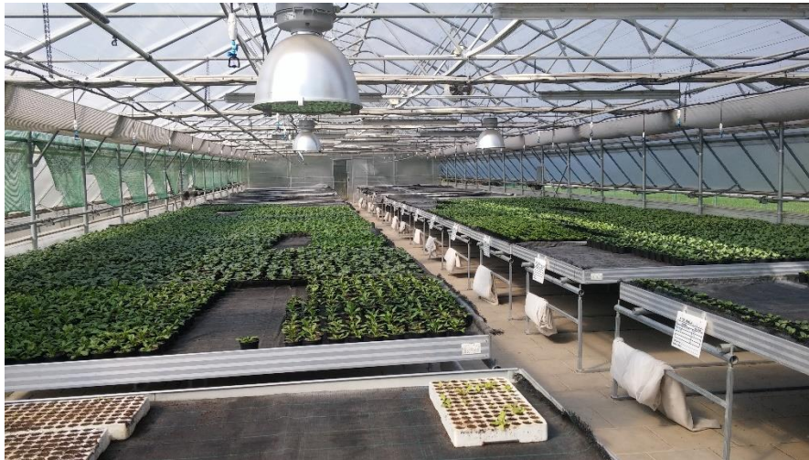
Slika 2.5. Asimilacijske svjetiljke u plasteniku Poljoprivredno šumarske škole u Vinkovcima
