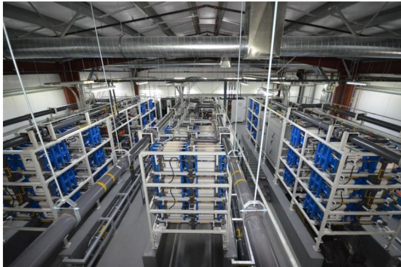
Slika 6.8. Primjena Vanadij-redoks sustava u Kaliforniji [4]
