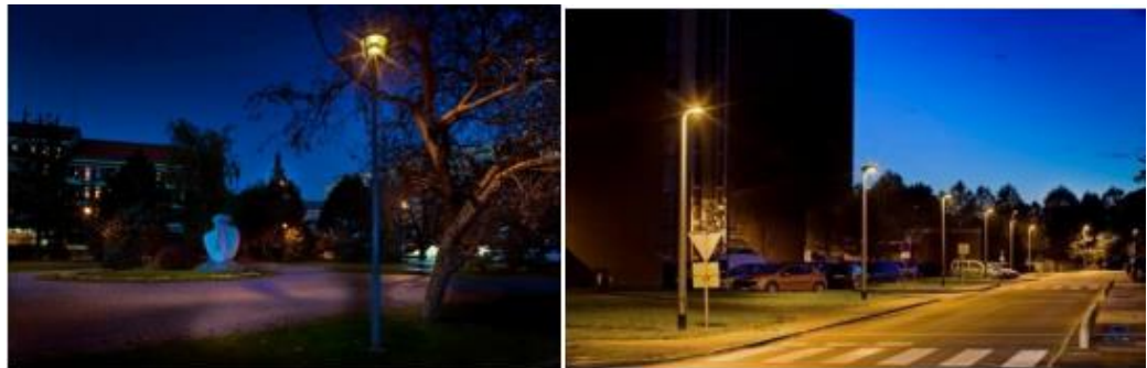
Slika 4.2. Lijevo je prikazana rasvjeta za pješake, a desno javna rasvjeta za cestovni promet [6]
