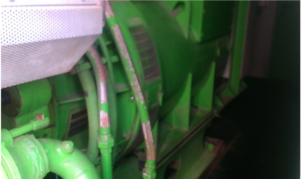
Slika 5.20. Prikaz generatora bioplinskog postrojenja Landia d.o.o.
