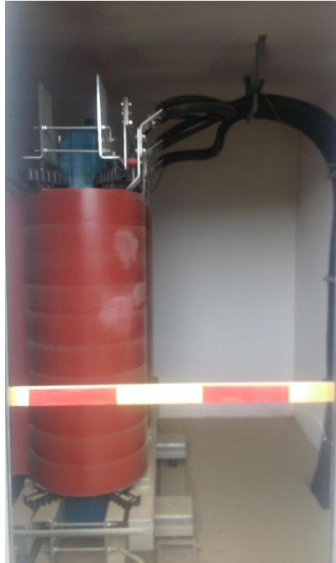
Slika 5.22. Unutrašnjost transformatorske stanice
