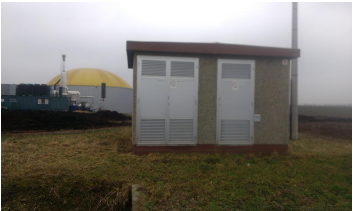
Slika 5.23. Transformatorska stanica HEP-a
