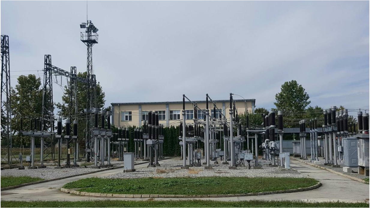
Slika 3.1. Transformatorska stanica (mjerni transformatori) - Osijek, 2017.
