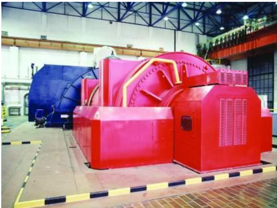
Slika 2.1. Turbogenerator termoelektrane Plomin u Hrvatskoj, 1x247 MVA [3]
