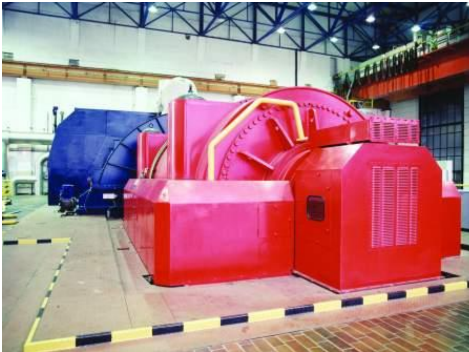
Slika 2.1. Turbogenerator termoelektrane Plomin u Hrvatskoj, 1x247 MVA [3]
