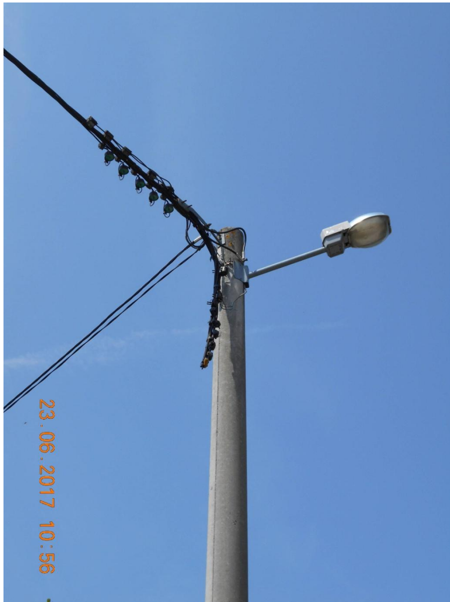
Slika 3.4. Zatezni betonski stup s kućnim priključkom i javnom rasvjetom
