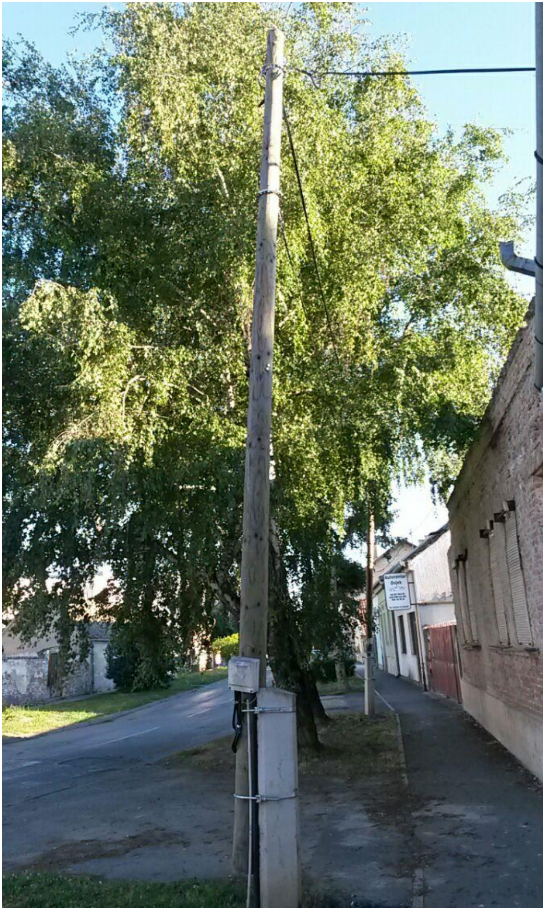
Slika 2.6. Drveni stup s betonskim temeljem i samonosivim kabelskim snopom
