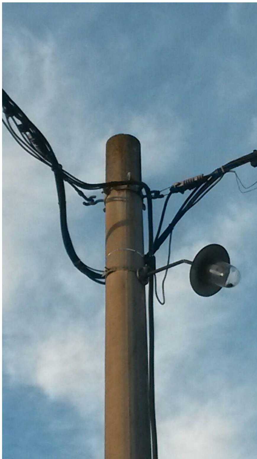
Slika 3.6. Kutni betonski stup s javnom rasvjetom
