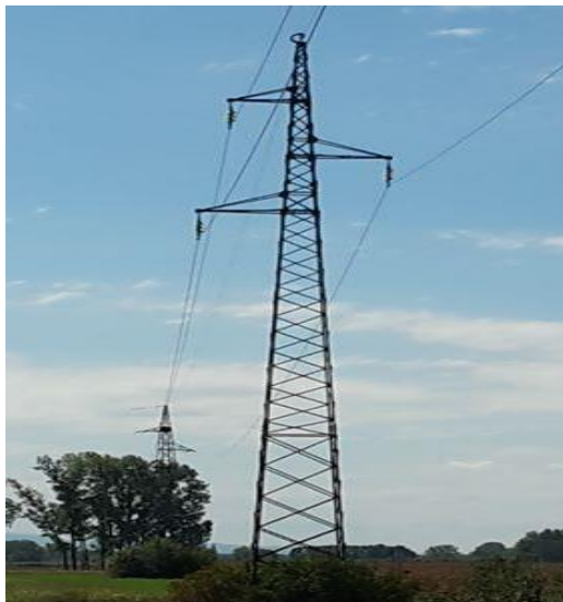
Sl. 2.7. jednostruko čelično-rešetkasti stup "jela"
