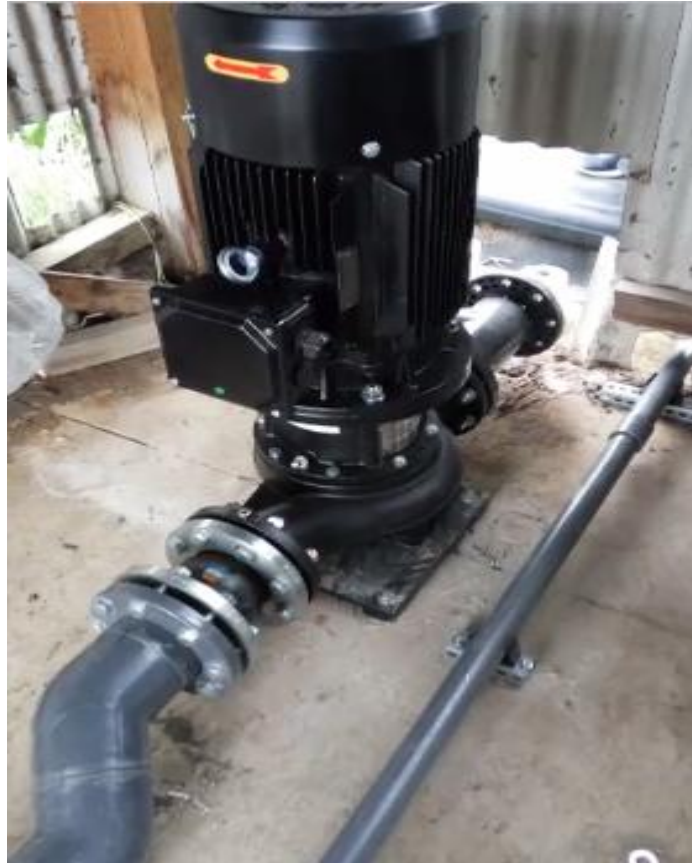
Sl.13. Nova fotonaponska električna crpka [3]
