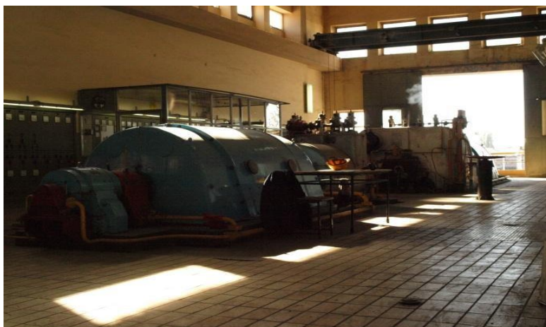
Slika 7.4. Generator Rade Končar 2,5 MW
