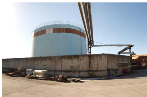
Slika 4.3. Spremnik za mazut u Tvornici šećera Osijek
