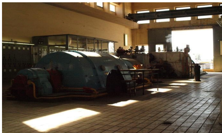
Slika 7.4. Generator Rade Končar 2,5 MW
