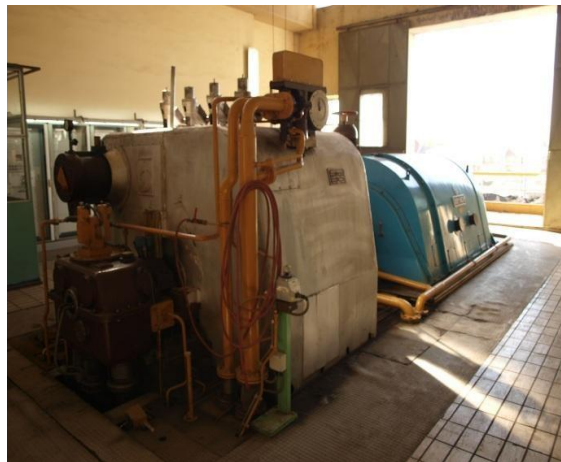
Slika 6.4. Turbina 10 MW u Tvornici šećera Osijek
