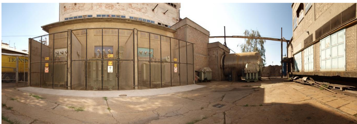
Slika 8.1. Transformatori 35/6,3 kV u Tvornici šećera Osijek
