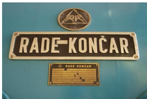
Slika 7.2. Generator Rade Končar 10 MW
