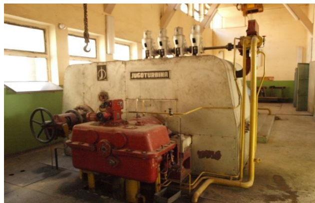
Slika 6.3. Turbina 6 MW u Tvornici šećera Osijek
