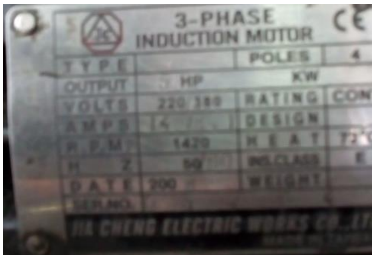
Slika 4.6. Natpisna pločica EM koji pogoni pumpu za centralno podmazivanje stroja, (Fotografirano 12.11.2017.)
