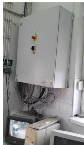
Slika 4.3 Razvodni ormar za sondu
