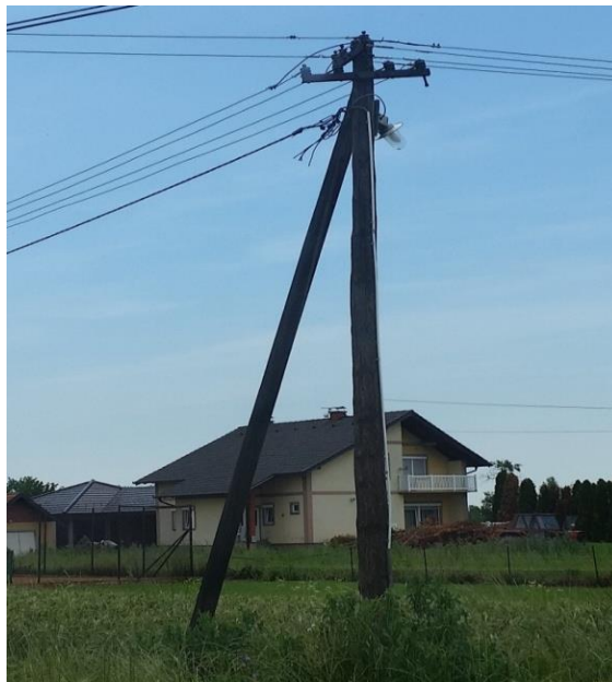
Sl. 3.7. Drveni odcjepni 10 kV stup s podupiračem
