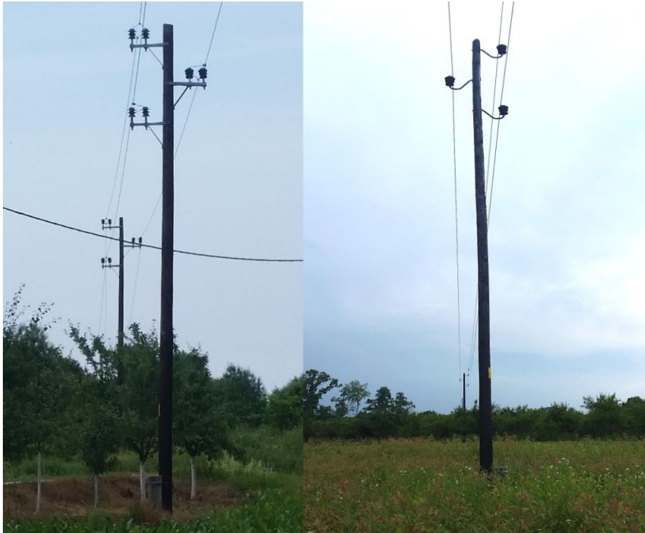
Sl. 3.8. Drveni nosivi linijski 10 kV stupovi s različitim poduporama
