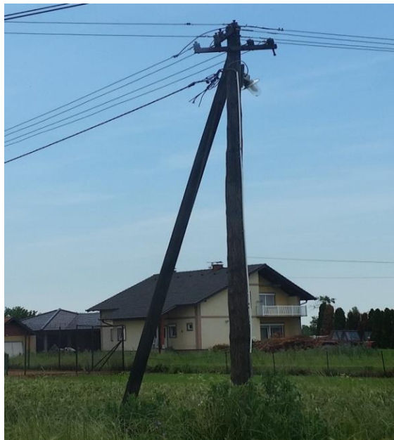
Sl. 3.7. Drveni odcjepni 10 kV stup s podupiračem
