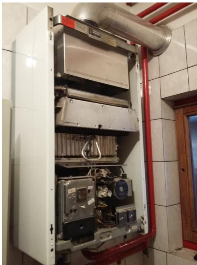
Slika 4.8. Standardni kombi bojler instaliran na katu, Vaillant VCW INT 24-10 H
