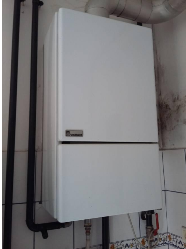
Slika 4.7. Standardni cirkulacijski bojler instaliran u prizemlju, Vaillant VC INT 280E
