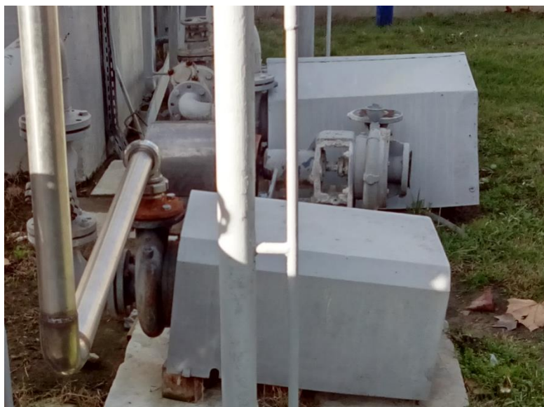
Slika 4.3. Pumpe evaporativnog kondenzatora
