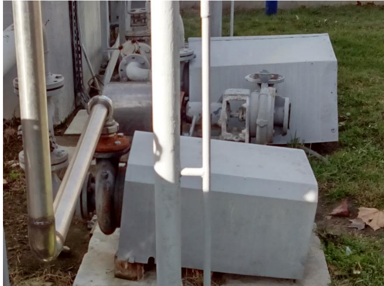
Slika 4.3. Pumpe evaporativnog kondenzatora
