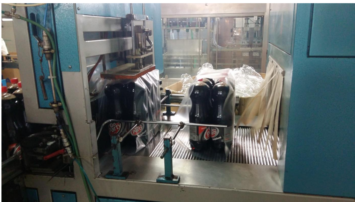
Slika 3.26. Ulaz u termotunel
