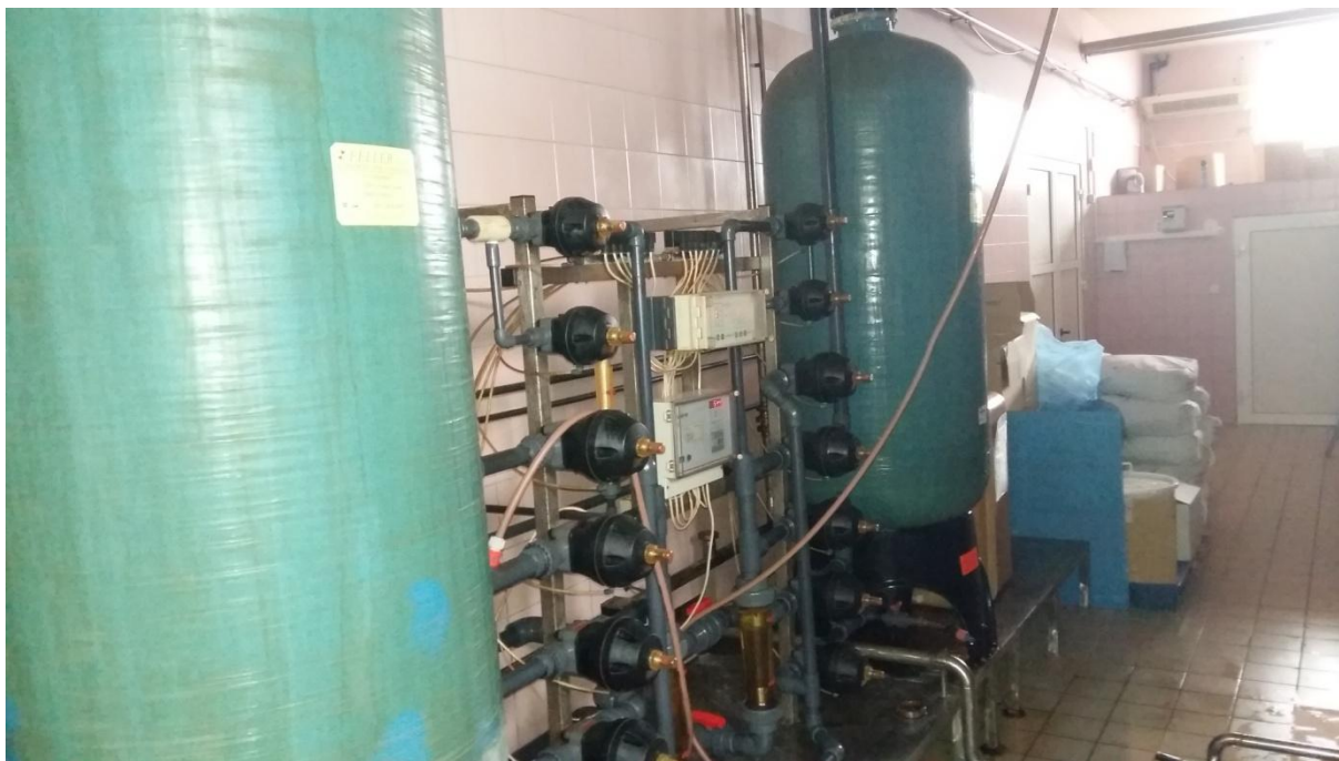
Slika 3.1. Sustav za omekšavanje vode – omekšivači (1 i 2)
