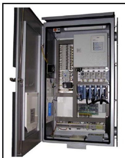
Slika 8.2. Razvodni ormar sustava motrenja Končar - TMS [76]
