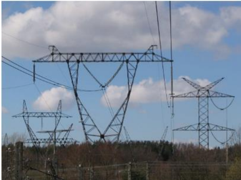
Sl. 3.15. Opći pogled na 110 kV poligon [10].
