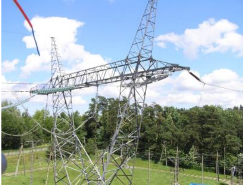
Sl. 3.14. Pogled na 400 kV poligon [10].
