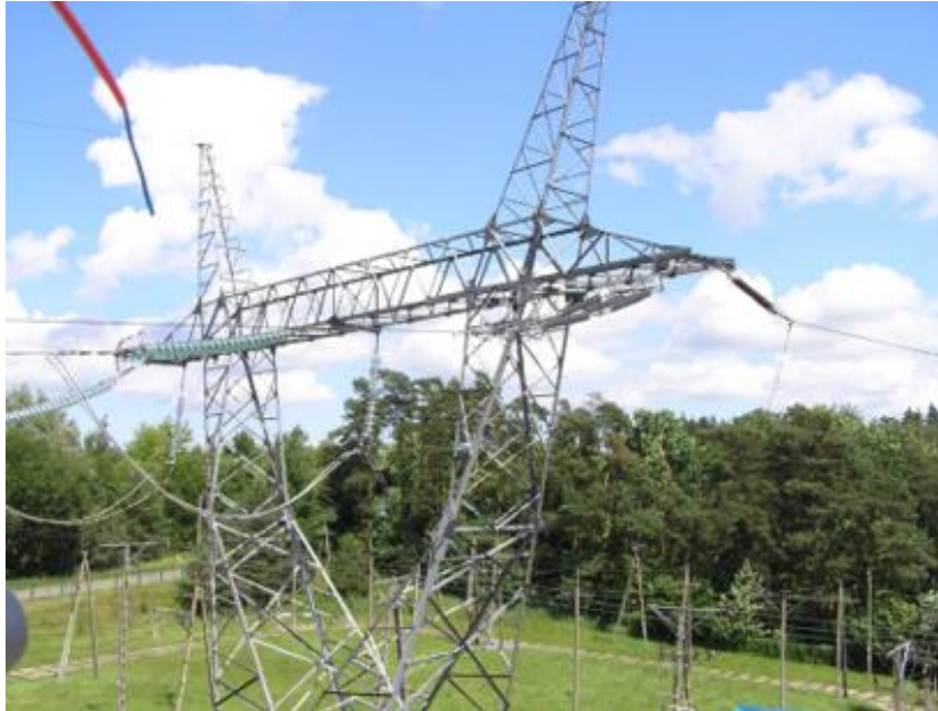
Sl. 3.14. Pogled na 400 kV poligon [10].
