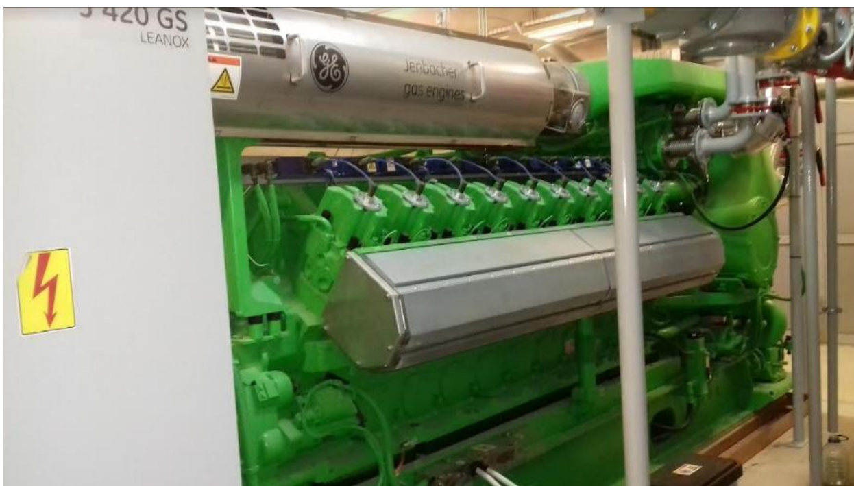
Slika 3.9. Plinski Otto motor Jenbacher J 420 GS u bioplinskom postrojenju Klisa [fotografirano 23.8.2018. u Osijeku]
