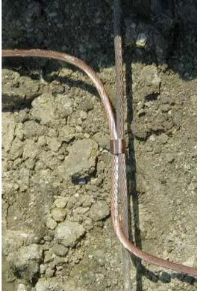
Slika 2.3: Primjer uzemljivača (bakreno uže) [3]
