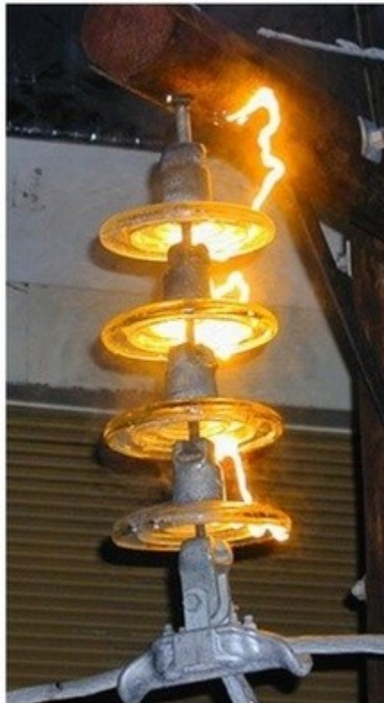
Sl.3.2.1. Proboj izolacije tijekom ispitivanja onečišćenjem
