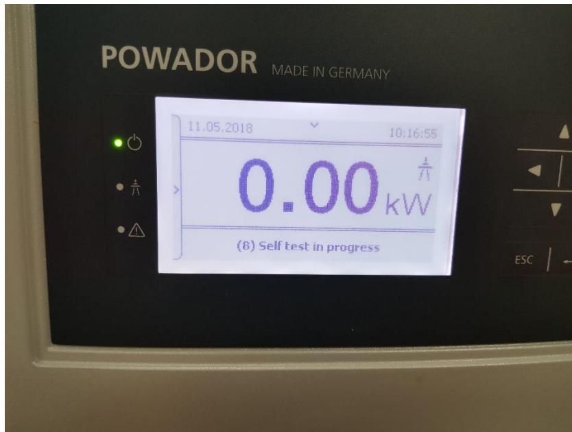
Slika 2.3. Prikaz upravljačke ploče izmjenjivača
